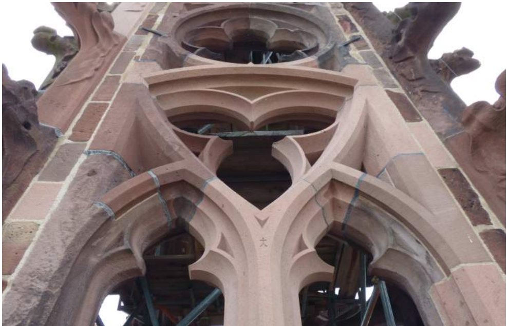
Abb. 5: Der Turmhelm gegen Ende der Sanierungsphase im Jahr 2016: Im Foto sind zahlreiche verschiedene Sandsteinvarietäten zu erkennen, nämlich Steine aus Allmendsberg und bauzeitliche Steine aus Tennenbach, neues Material aus Lahr-Kuhbach und dem Odenwälder Neckartal, links oben ein Eckstein mit Krabbe aus Seedorfer Plattensandstein.
